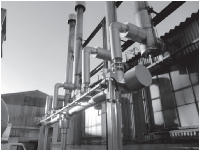
図4 ボイラーの燃焼排ガスの排出煙突
